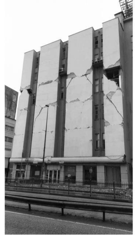
Deprem bölgesindeki çoğu PTT binası kullanılamaz halde.
